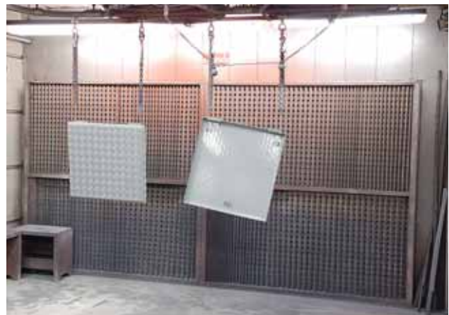
Fig. 5: poste de peinture au pistolet avec paroi aspirante. L'air frais provient de la partie opposée du local. Le système de suspension est équipé d'un dispositif rotatif permettant de toujours pulvériser les pièces de face.
